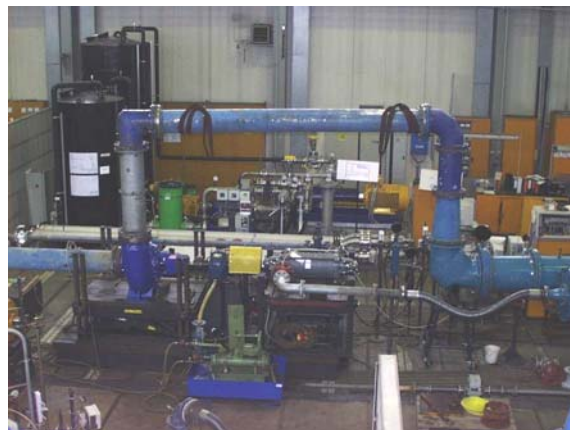
Abb. 12: Fördermodul (Spiralgehäusepumpe als PAT, Stirnradgetriebe, neunstufige Gliederpumpe) auf dem Prüffeld der KSB AG
