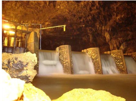
Abb.6: Alte unterirdische Wehranlage mit Radarmesspegel des IWG
