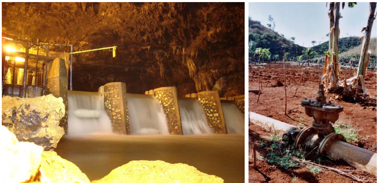
Abb.9 Alte unterirdische Wehranlage mit Radarmesspegel des IWG / Stillgelegte Wasserleitung
